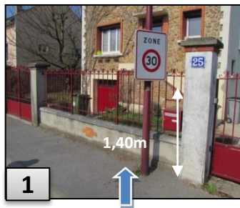
1 Hauteur de signalétique trop basse (< à 2,20m)
